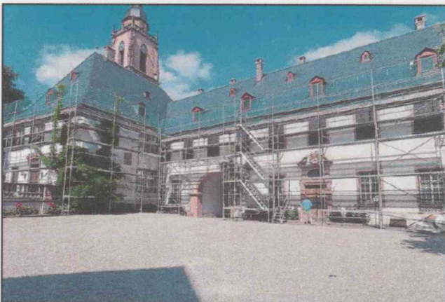
Um Kosten zu sparen, bleiben die zur Dachsanierung aufgestellten Gerüste am Viktor- und Kavaliersbau für die Arbeiten an der Fassade stehen.
